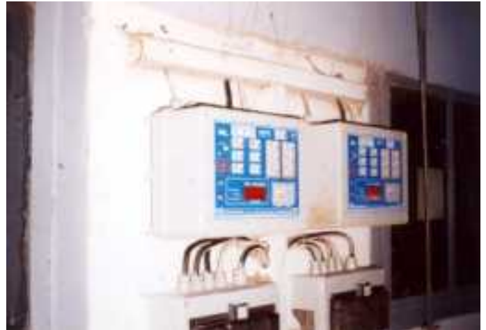
Obr. 8: řídící jednotka pro automatickou termoregulaci
